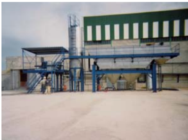
Depuradora de aguas residuales industriales. Caudal 150 m 3 /hora
