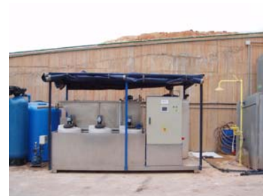
Depuradora de aguas residuales industriales móviles. Caudal 2 m 3 /hora
