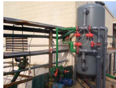
Filtro de pretratamiento osmosis. Caudal 100 m 3 /día
