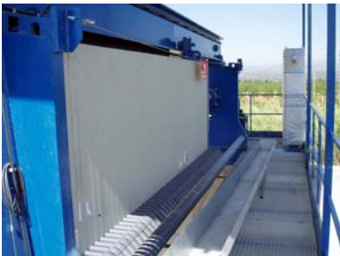
Filtro prensa para la deshidratación de lodos.
