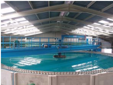
Depuradora de aguas residuales industriales. Caudal 300 m 3 /hora
