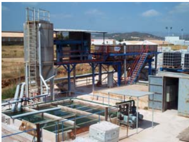
Depuradora de aguas residuales industriales. Caudal 190 m 3 /hora
