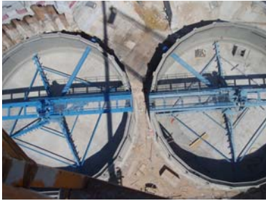
Depuradora de aguas residuales industriales. Caudal 1.000 m 3 /hora
