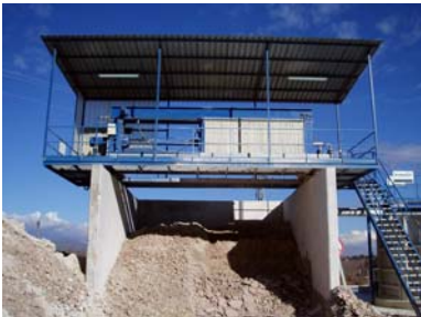
filtro prensa para la deshidratación de lodos.
