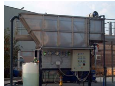
Depuradora de aguas residuales industriales. Caudal 5 m 3 /hora
