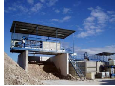
Depuradora de aguas residuales industriales. Caudal 80 m 3 /hora
